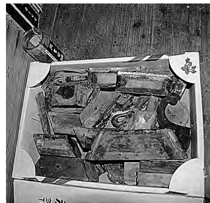
図2-24 薬師堂 図2-22の観音菩薩像の台座の崩壊した部材などが段ボール箱に積み重ねられて保管されている
