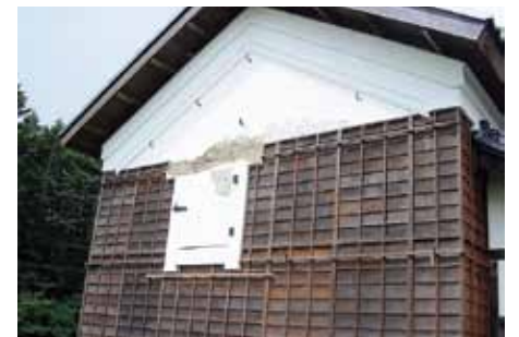
写真1 開拓の村にある剥落した漆喰壁の建造物
