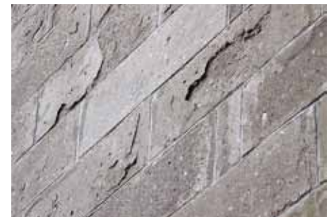
写真2 旧小樽新聞社南面の劣化状況
