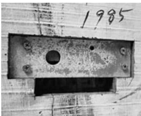
展示フックの腐食（処置前）
