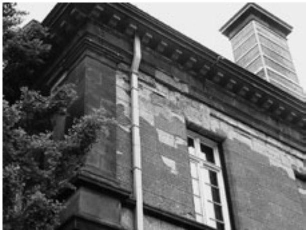
図 6 重要文化財旧日本郵船小樽支店の石壁の劣化
