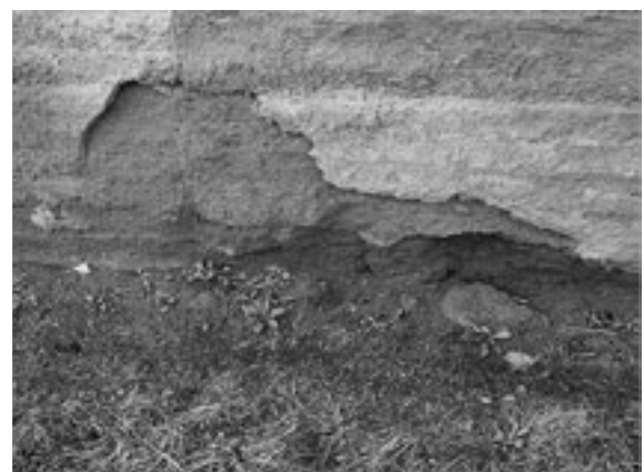
図5 史跡志波城跡の復元築地塀の凍結劣化
