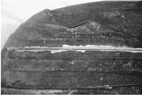
図3. 部材の剥ぎ目が緩み、剥ぎ目周辺に生じている表面塗膜の剥落
