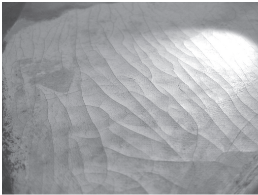
図 8. 経年による亀裂
