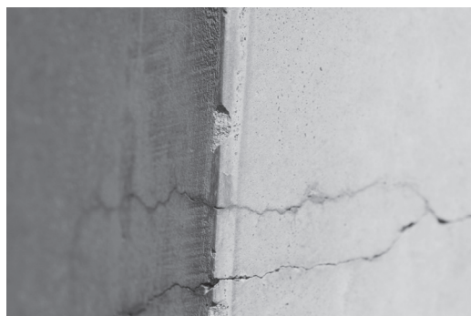
図 7. 角の欠損と亀裂
