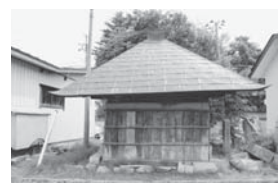
図7-3 調査開始時の竹森薬師堂背面土蔵造りによる薬師堂が経年劣化や東日本大震災の影響によって大きく傾いているのがわかる。
