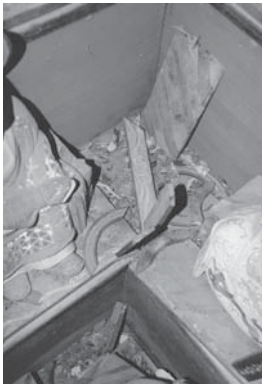
図7-32 脱落部材の混在
