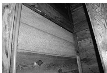
図8-1 高湿度環境によって壁に発生した徴
