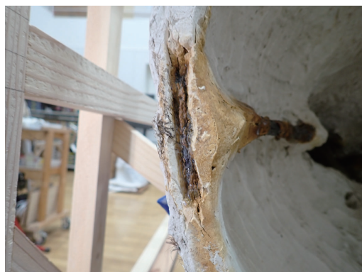
図8 番線の錆による欠損（周縁部）
