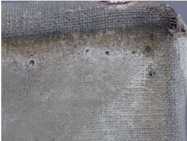
図11. 上辺右上の剥落箇所
