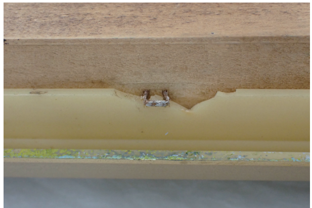
図44. 入子の破損箇所
