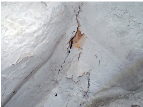
▲図4 正面男性像股間付近の亀裂
