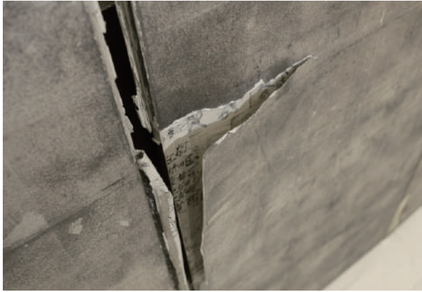
図37. 裏張り紙の破れ_修理前
