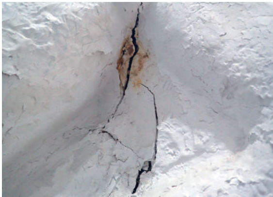
▲図9 白色材除去で亀裂がさらに明らかになった
