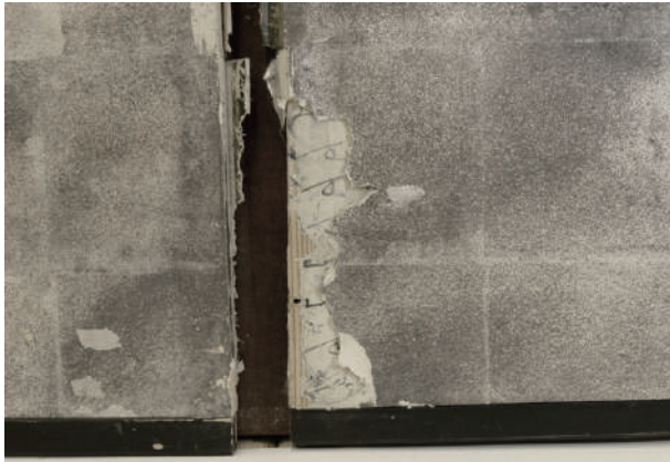
図39. 裏張り紙の破れ_修理前
