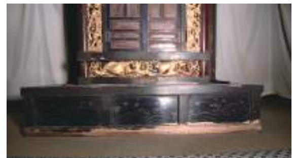
▲基台が歪んでいる・表面が剥落
