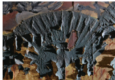
図10. 松葉部分（修理前）
