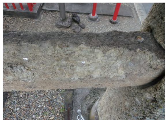
図3. 測定点Bの石材表面状況
