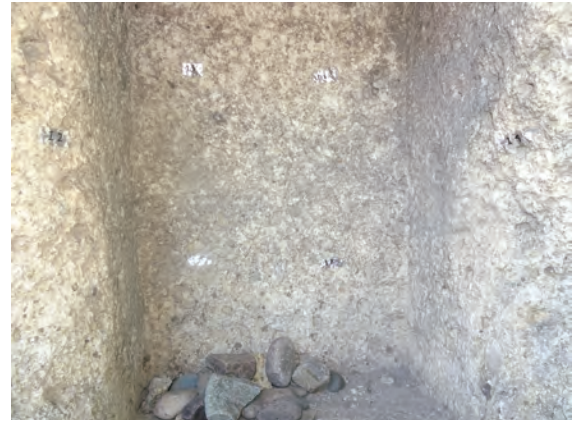
図7. 測定点I（貫穴部分）の石材表面状況
