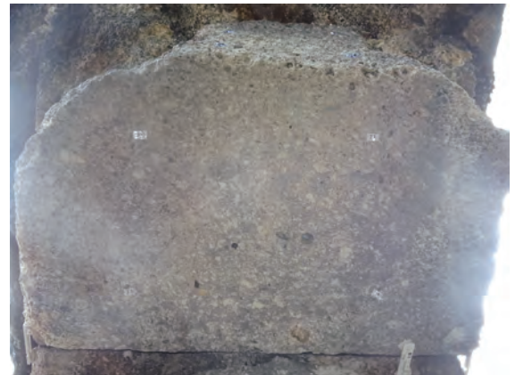
図8. 測定点J（笠木剥ぎ石部分）の石材表面状況
