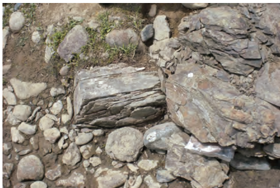
図1. 毛越寺庭園遣水の景石の劣化
