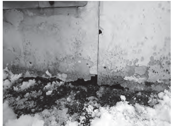
写真14. 覆屋基底部の壁面欠損状況
