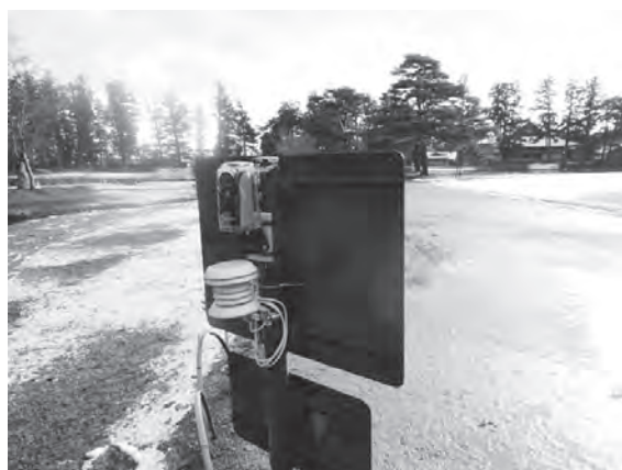
図1. 温湿度測定装置およびタイムラプスカメラの設置状況
