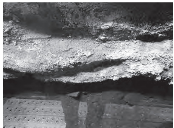
写真5. 土嚢部分に塩類が析出している状況
