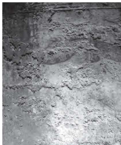
図11. 東壁の青龍の近くに発生したカビの状況
