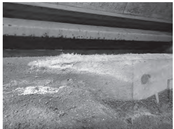
写真4. コンクリート面に塩類が析出している状況
