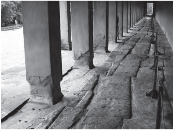
図2：アンコール・ワット回廊の柱の剥離劣化
