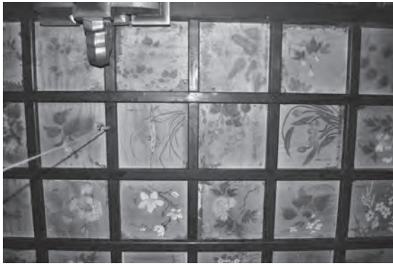
図3 修復前の状態
