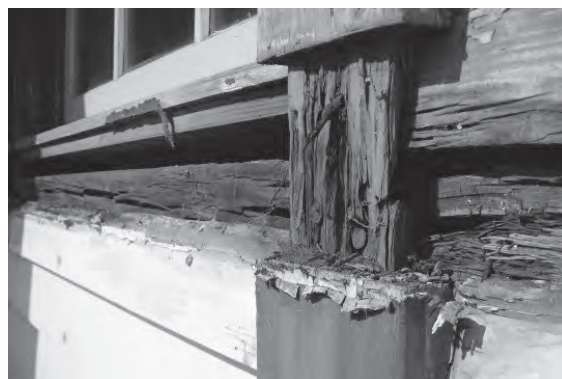
写真4 窓台の褐色腐朽
