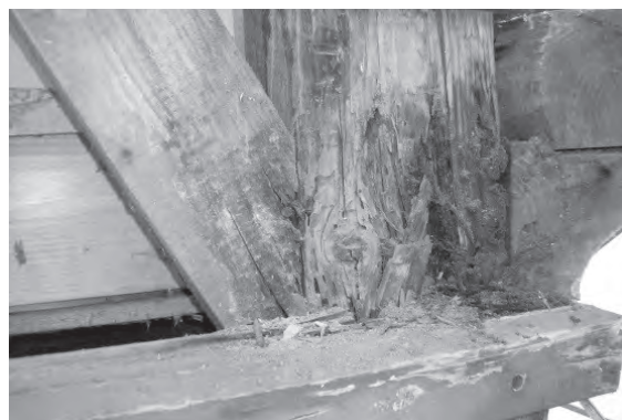
写真3 隅柱の褐色腐朽
