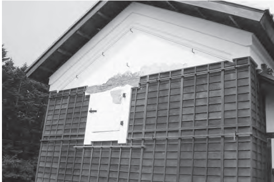
図6. 開拓の村にある剥落した漆喰壁の建造物
