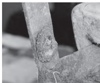
図5. 突起部の層状腐食
