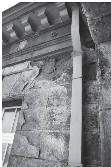
写真3：石材の表層剥離
