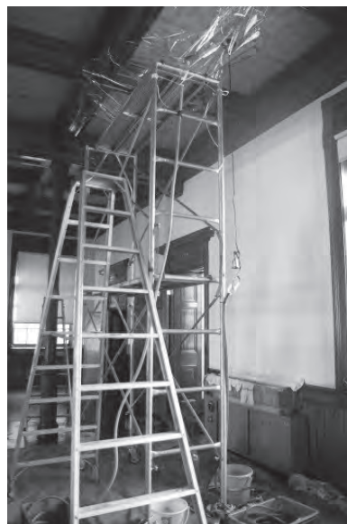
写真4：1階天井の漏水状況
