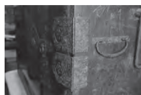
図5. 金属部の腐食
