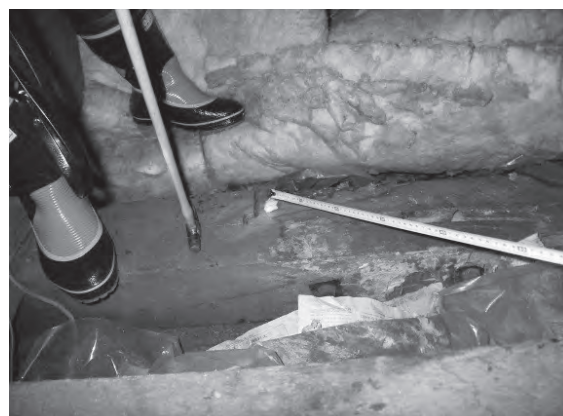
写真5：小屋裏木部の腐朽
