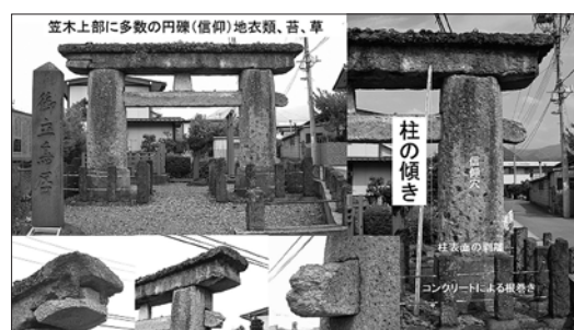
図14 石鳥居の変形と劣化
