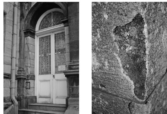
図7 旧日本郵船小樽支店入り口下壁部分の劣化状況
