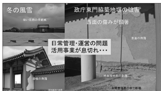
図11 城輪柵跡築地塀の凍結被害
