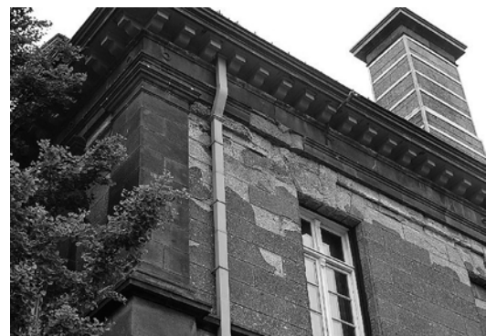
図6 旧日本郵船小樽支店の石壁の劣化状況
