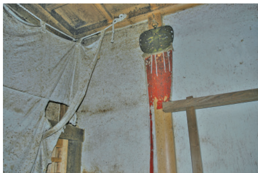
写真17 土蔵内部に繁殖しているカマドウマとその糞害
