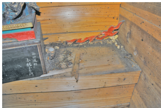
写真20 堆積物と脱落した部材が混在している様子
